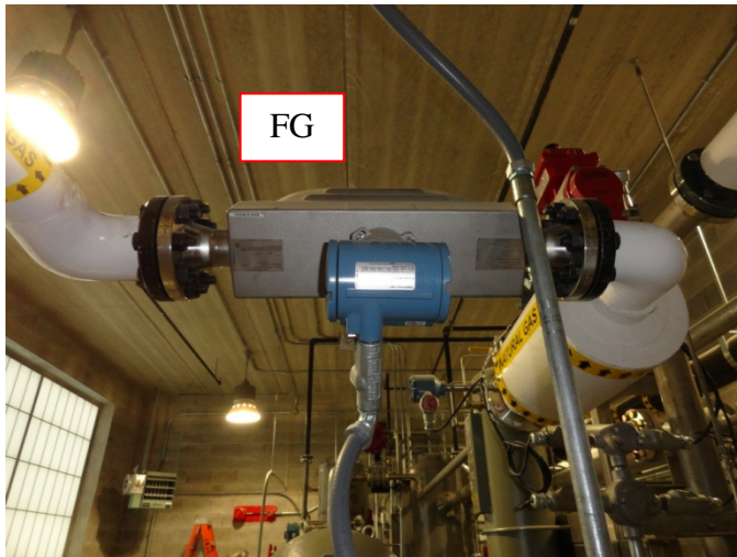
Turbine Gas Meter (FG)
