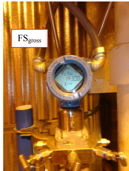
HRSG Gross Steam Meter ( FS_{gross} )
