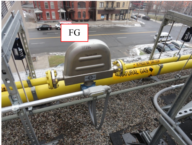
Turbine Gas Meter (FG)
