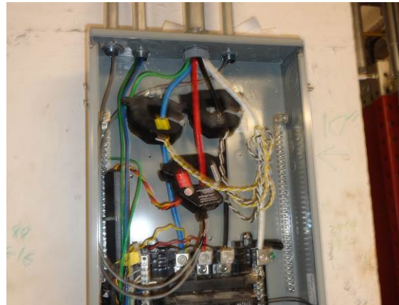
Veris H8035 Power meter (WPAR)
