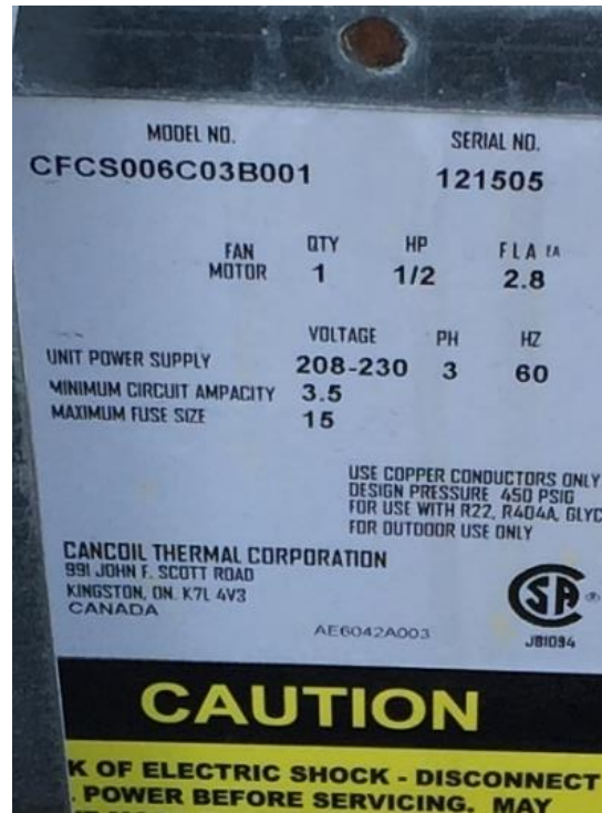
Dump Fan 2 nameplate
