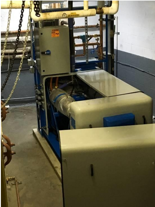
100 kW Cogen Unit
