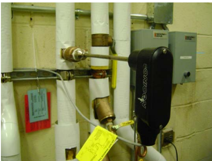
Flow Meter (FW)
