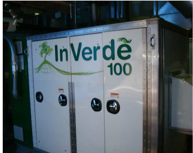
InVerde 100 cogen unit (TYP)
