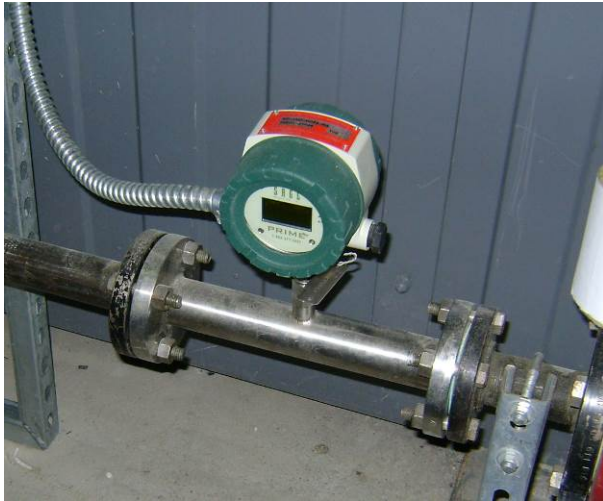
Cogen unit gas meter (TYP).
